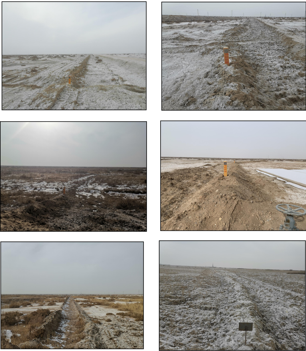
图2.3-7 油气集输管线现场情况
