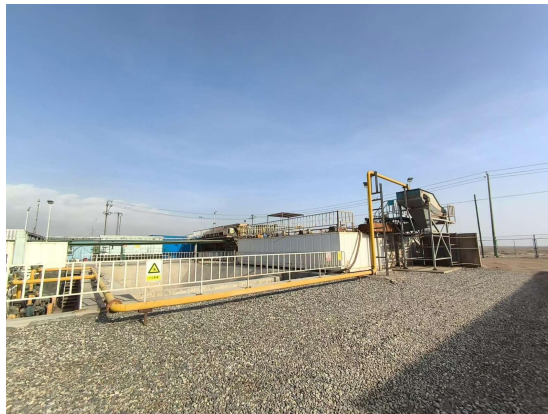
图 6 现有磺化泥浆废弃物处理装置
