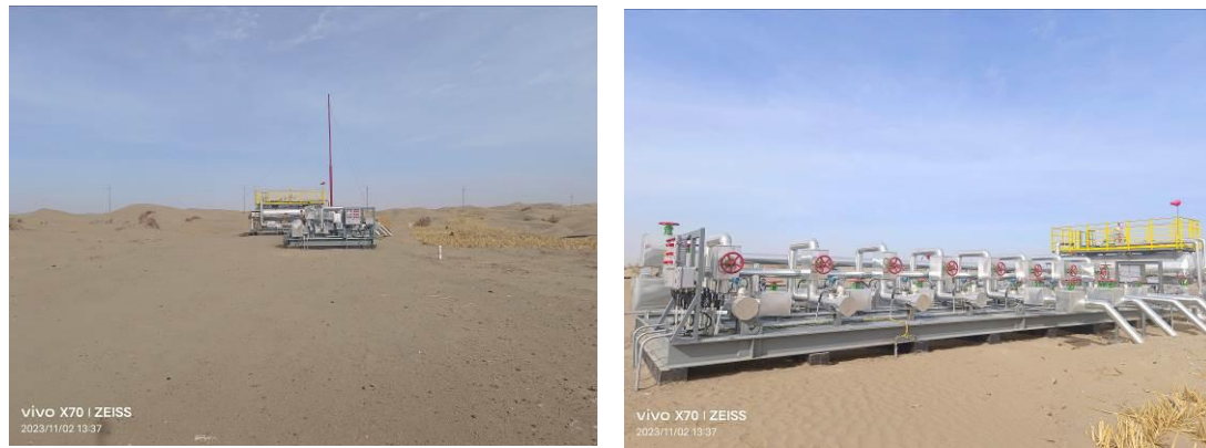
图 2.3-4 满深 7 计量阀组站现场情况
